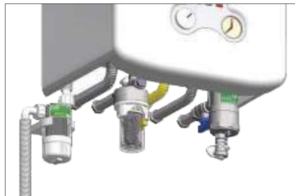
Esempio di installazione di: Neutralizzatore, filtro dosatore PolyFAR e defangatore CompactFAR sotto una caldaia domestica.
